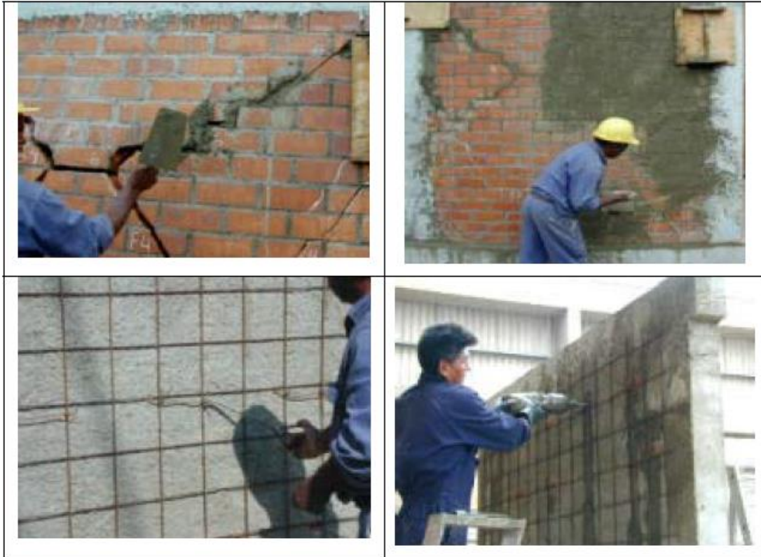
Imágenes 3.2.1-3., 3.2.1-4., 3.2.1-5., 3.2.1-6. Proceso de reforzamiento con grapas, malla electro-soldada y pañete. Fuente: SAN BARTOLOMÉ, A., ARATA, A. y DÍAZ, V. Investigación, arriostamiento de tabiques de albañilería existentes en fachadas de edificios con voladizos. Universidad Católica del Perú . [En línea] 2007. Disponible en web: http://blog.pucp.edu.pe/media/688/20070424-Arriostamiento%20de%20tabiques%20existentes.pdf
