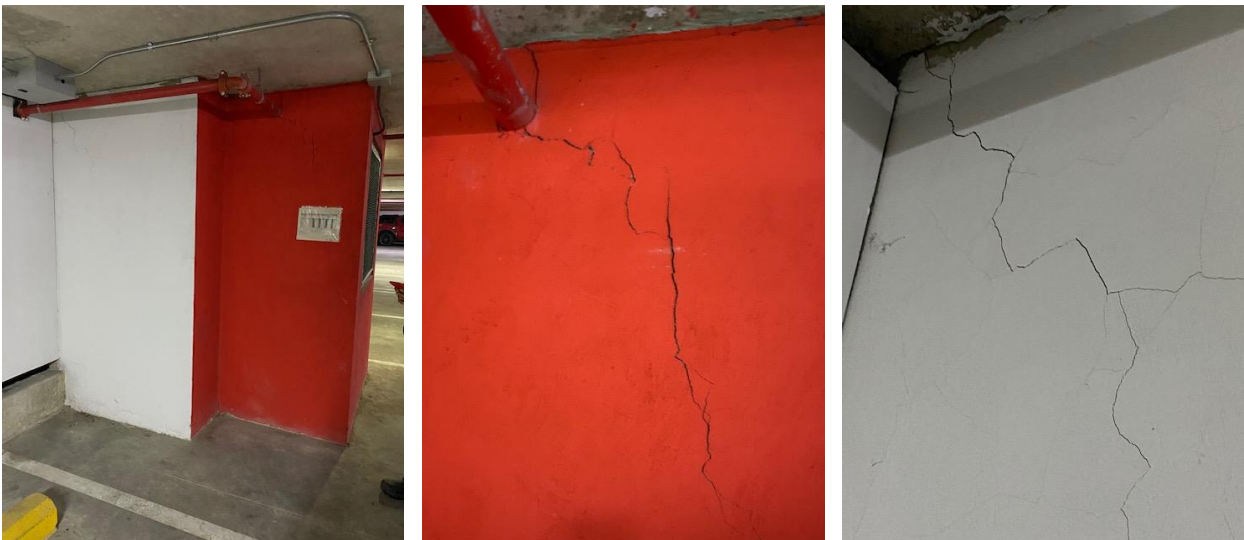
Muros de mampostería en el sótano 4 con grietas menores a 1.00 mm (LEVES) las cuales no ponen en riesgo la estabilidad de los muros.
