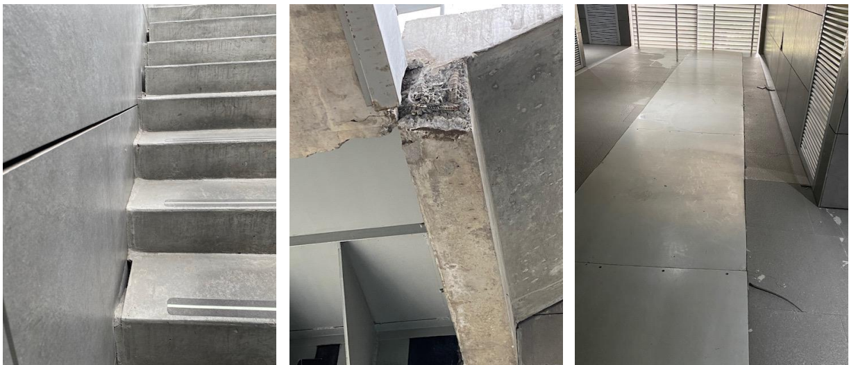
Foto izq. En varios sitios de la escalera de emergencia entre las torres 2 y 3 el mortero con que remataron el borde de la escalera se desprendió durante el sismo, allí debió dejarse la dilatación sin ningún material (aire) o haber instalado una masilla elástica.
