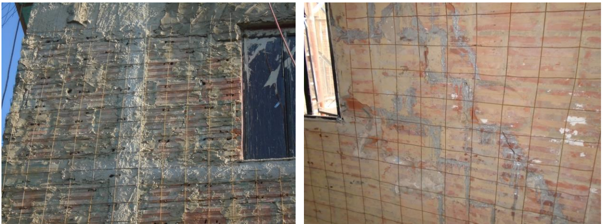
Reparación de grietas en muros de fachada e interiores con malla electrosoldada
